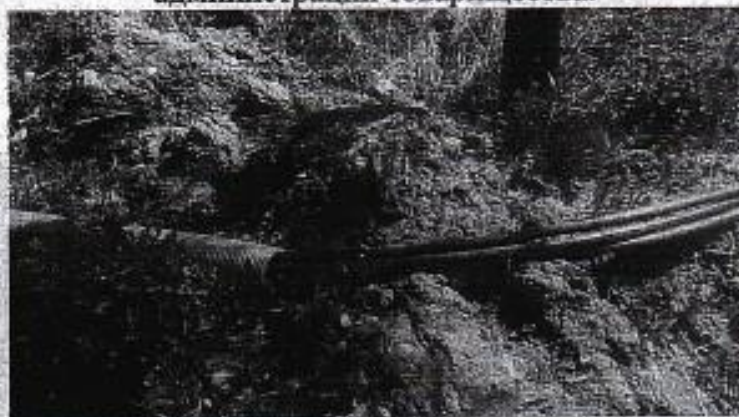
Фото №2 Кабельная линия около администрации.
