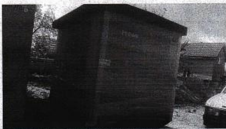
Фото №1 Не смонтированная трансформаторная подстанция около здания администрации товарищества.
