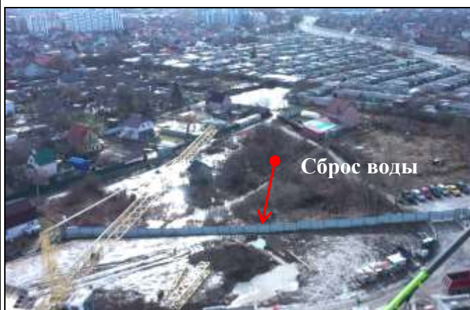
Фото 1. Сброс воды со стройплощадки детского сада
